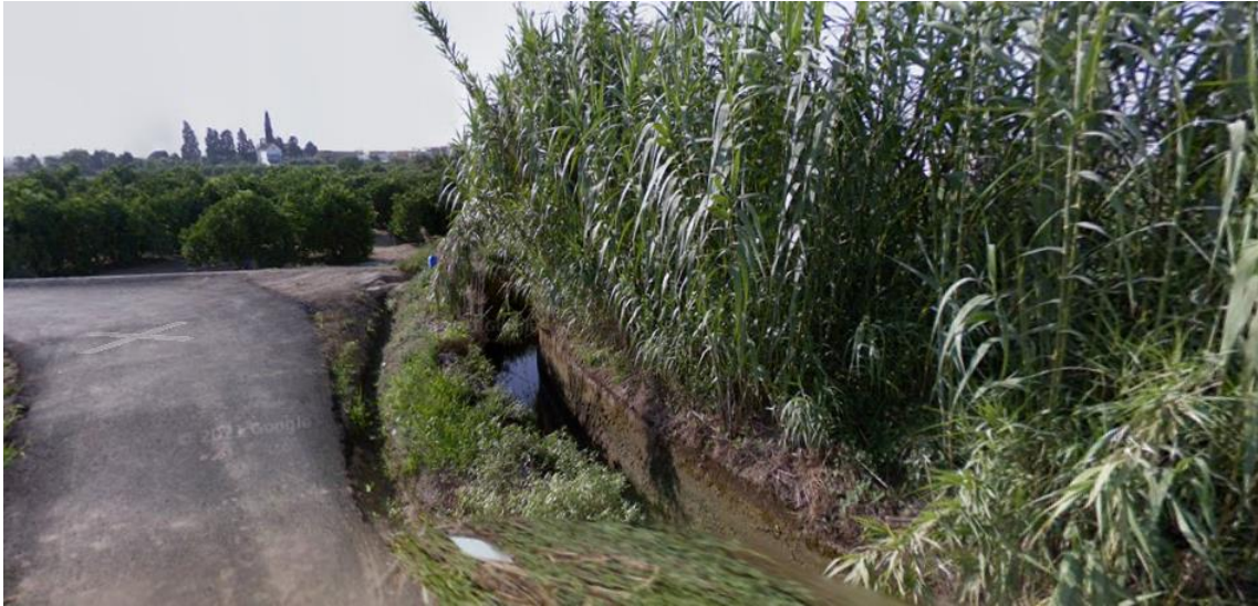
Acequia de Tormo en mal estado
